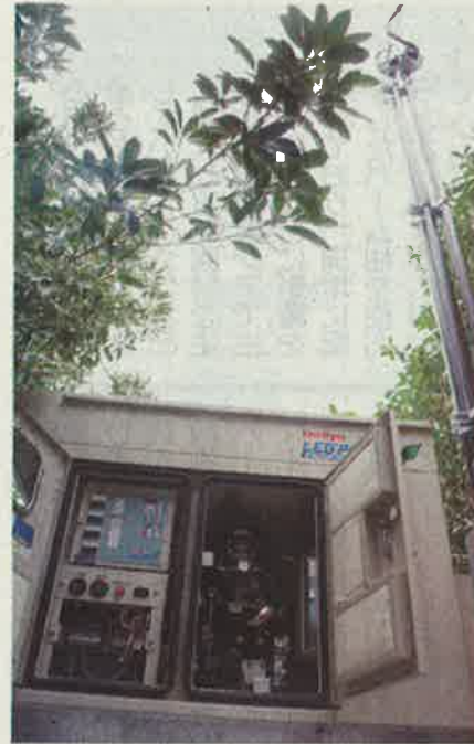
敷地内に設置された発電機。電線で施設につながっている
