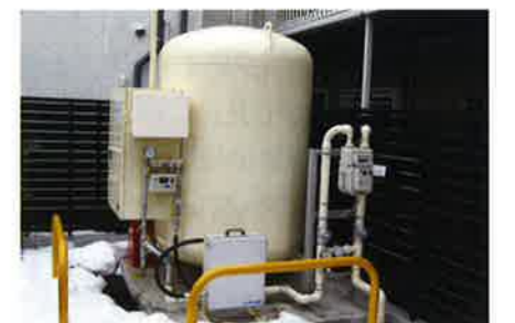
災害用バルク貯槽
