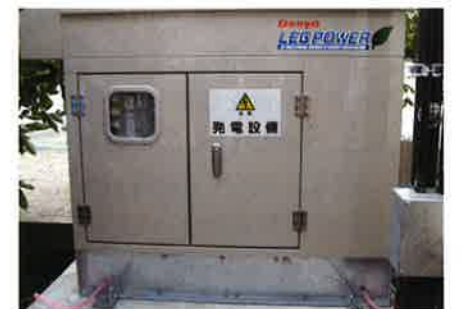
LPガス発電設備
